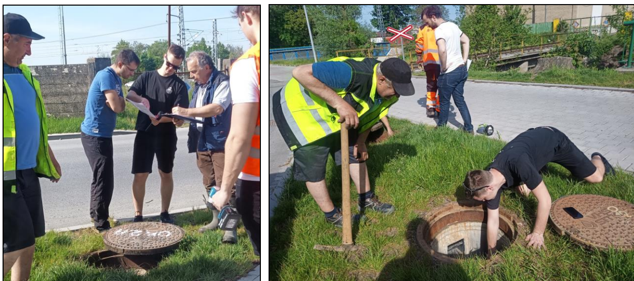
Přípravné práce pro zahájení měření ve vybraných profilech kanalizace (ul. Pískoviště, květen 2023).
